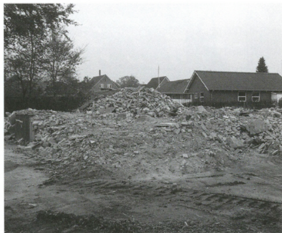
Oktober 2015: Futtrups villa er nu blevet til en stenbunke!
